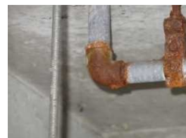
屋内排水管腐食
