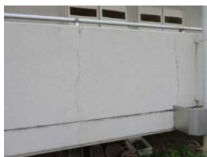
建物外壁クラック
