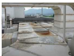
空調機排気ダクト腐食
