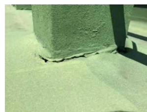
建物屋上防水劣化
