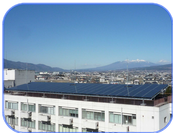
太陽光発電（医学部基礎研究棟）
