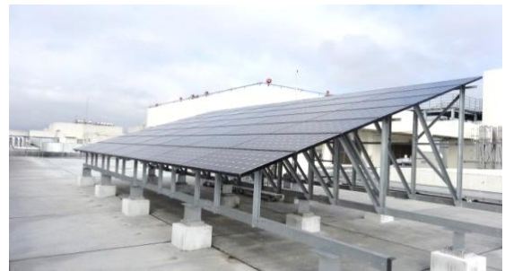
太陽光パネル（新病棟屋上）
