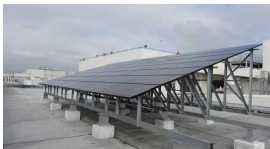
太陽光パネル（新病棟屋上）
