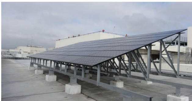
太陽光パネル(新病棟屋上)
